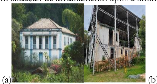
Figura 1 – (a) Fachada principal da Sede da FL conservada e (b) Vista geral da edificação em situação de arruinamento após a liminar
